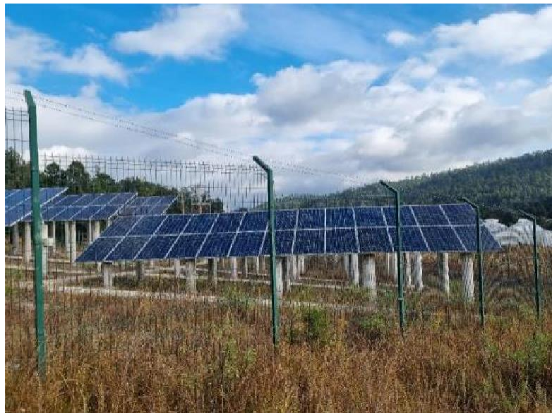
Planta solar para proporcionar energía eléctrica al anexo El Gato
